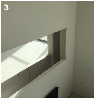
3 Pejsevæggen er ikke sikret mod falsk træk i siderne / The fireplace wall is not secured against false draft in the sides.
